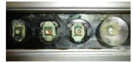
Abb. 2: Durch Eindringen von Feuchtigkeit stark korrodierte Kontaktzonen diverser unprofessionell vergossener HP-LEDs in einem als »IP67« deklarierten Lineargehäuse.
